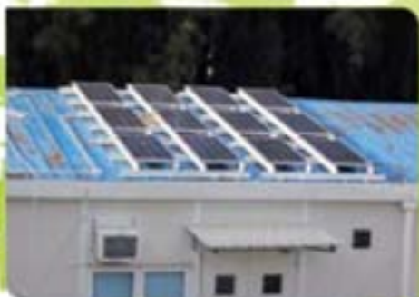
屋頂太陽能板 4
