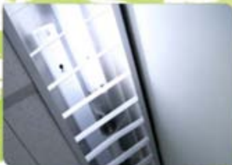
改裝照明系統，減少使用光管
